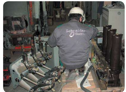
ECOFIT de un interruptor en MT.
