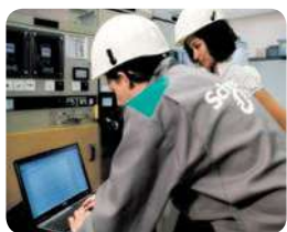
ProDiag, Diagnóstico del funcionamiento de un interruptor de potencia en MT
