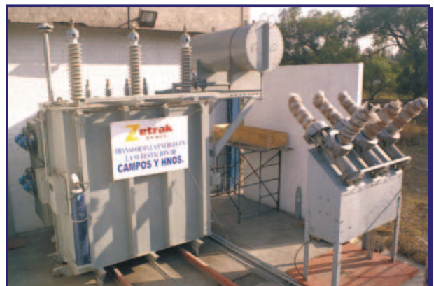
Transformador de 10/12.5/15 MVA, en 85 kV.
